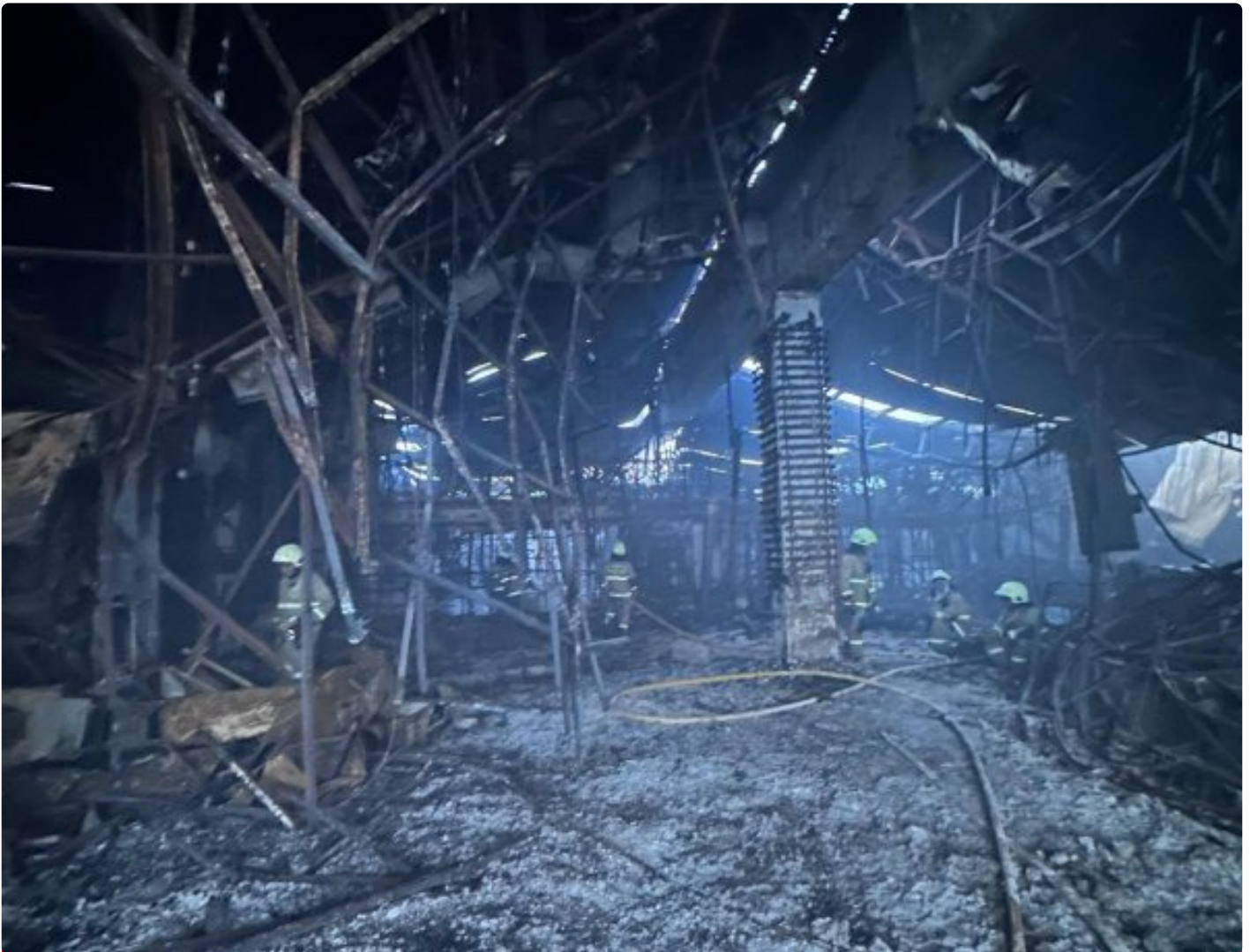
Glodok Plaza yang Hangus Terbakar
